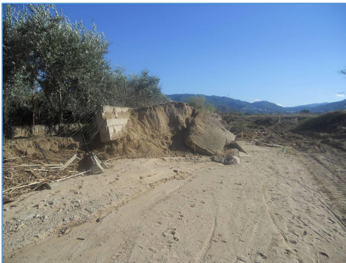
2.2.2.1- Rottura arginale Torrente Gennarito in destra idraulica, vista da valle.
