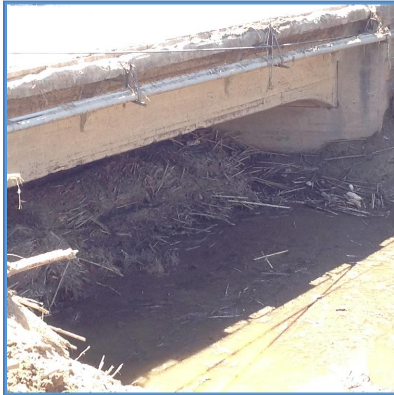
2.2.2 Particolare dell'ostruzione del ponte stradale
