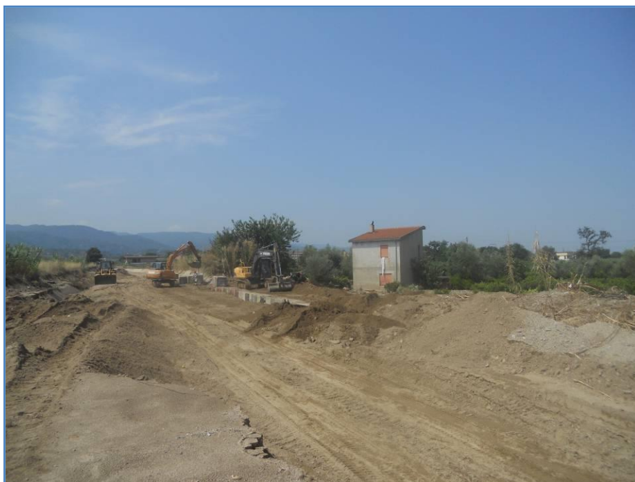
2.1.3.4 - Danni provocati dalla rottura dell'argine in sinistra idraulica.
