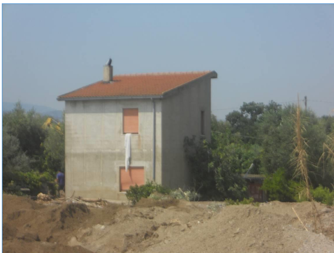
2.1.3.5 Danni provocati dalla rottura dell'argine in sinistra idraulica. Nel particolare la traccia del passaggio dell'onda di piena sul prospetto dell'abitazione di altezza superiore ai 2 metri
