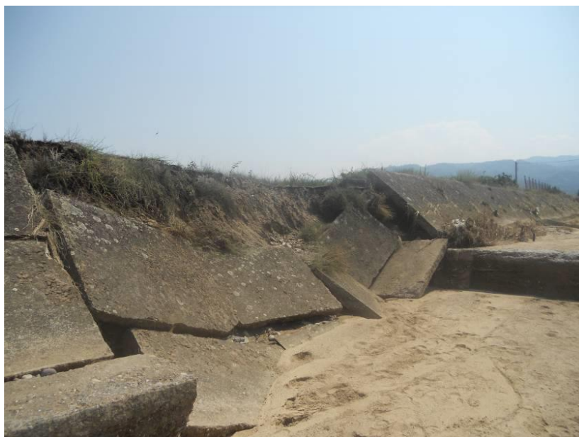
2.1.2.4 Rotta dell'argine del Torrente Fellino in dx idraulica
